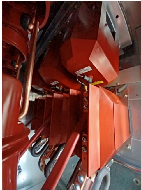
Figura 6.1 – Trasformatori di misura voltmetrici e amperometrici installati in cabina.
