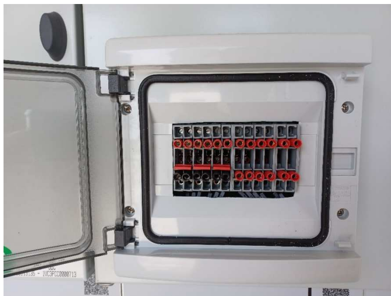
Figura 6.2 – Box di connessione alle uscite dei trasformatori di misura.
