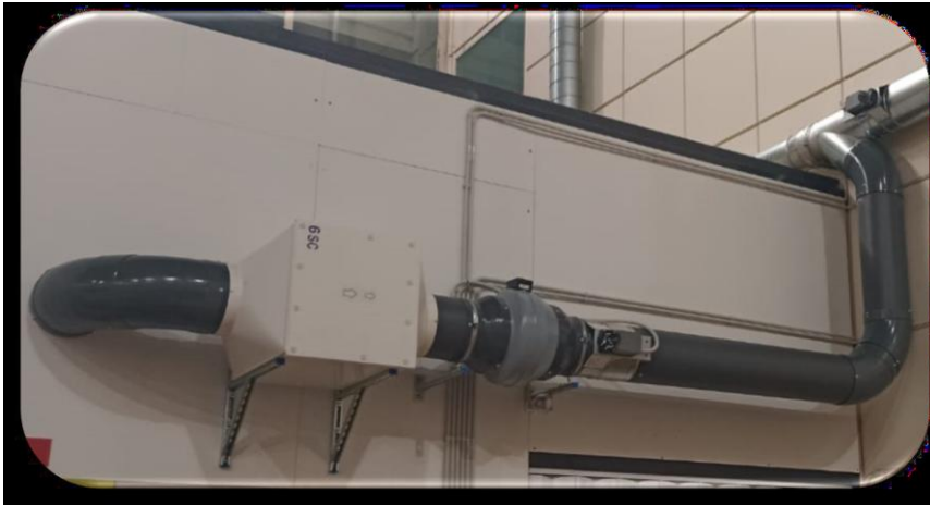
Figura 2. - Vista cassone/aspiratore/serranda elettroattuata serranda di sovrappressione/trasduttore di pressione
