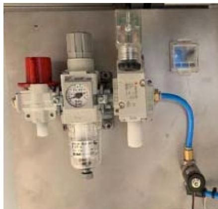
Figura 2. Elettrovalvola aggiuntiva per implementazione spin-blowing da integrare nella HMI standard dell'infrastruttura
